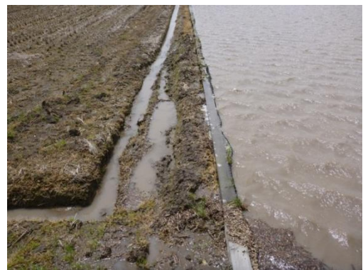
隣接水田からの漏水
