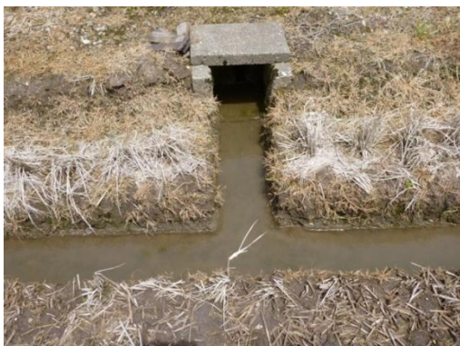
排水口が高いため水が抜けない
